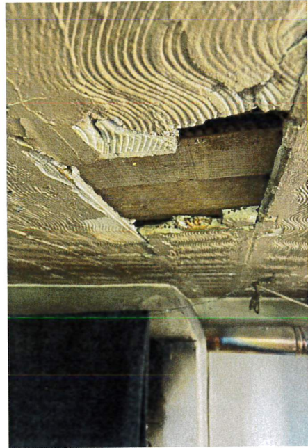
Photo 4 - Plafond de la cuisine
