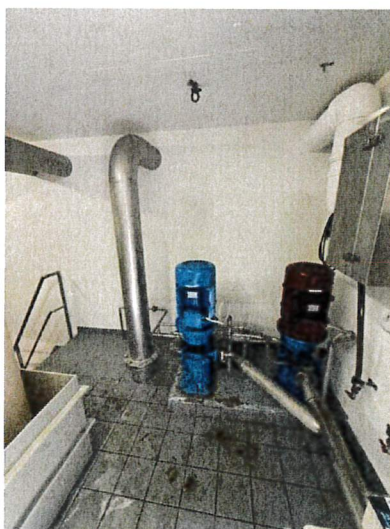
Les pompes dans la chambre de service à remplacer
