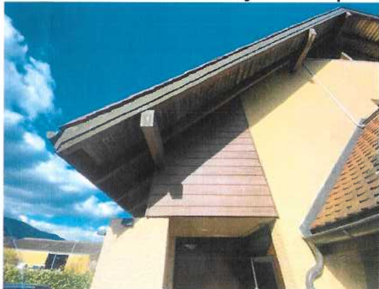
PHOTO NR 1 Bois sur la façade remplacé par de l'isolation.
